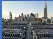
冷暖房・除湿空調
