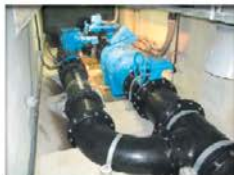
桃山台配水場 小水力発電
